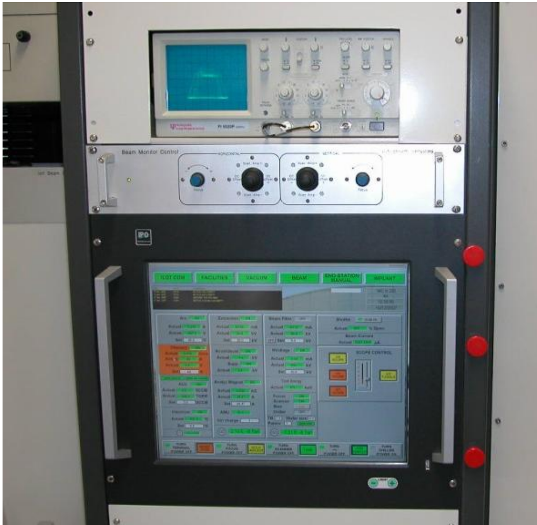
Figure 6: Panneau de contrôle du Beam Moniteur
