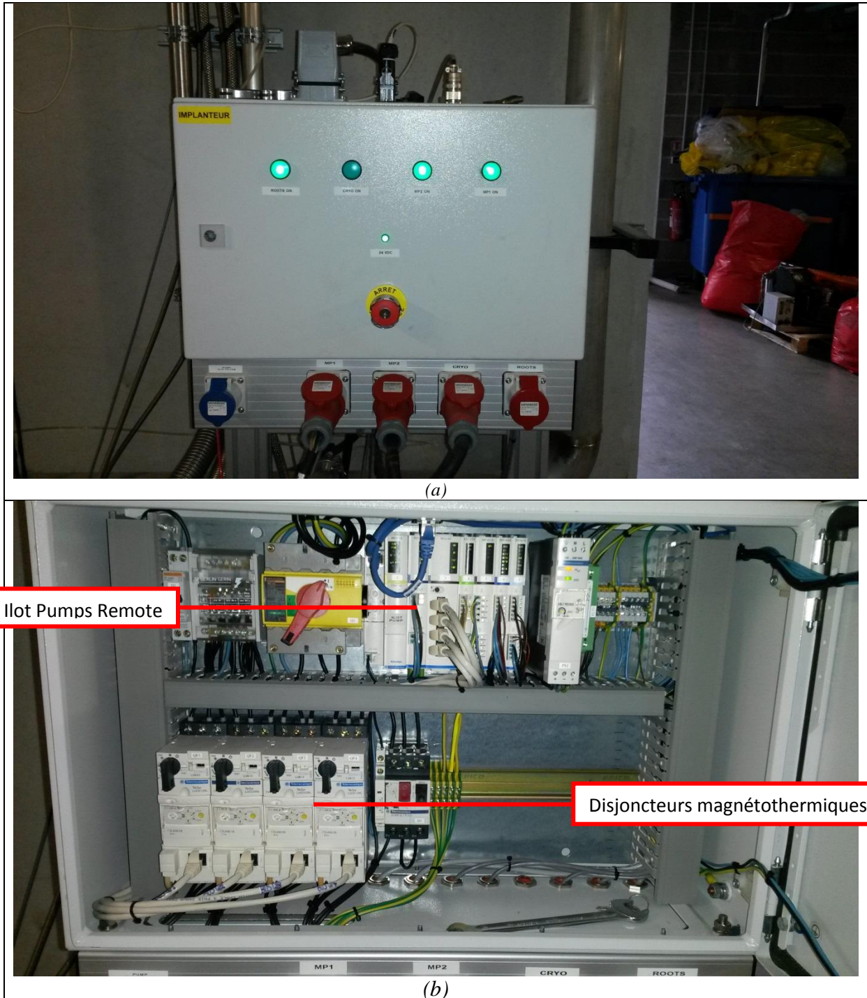
Figure 10: Rack pompes. (a) Panneau fermé – (b) panneau ouvert
