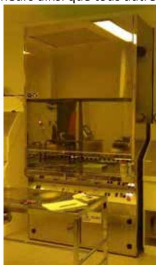
Hotte solvants pour la zone intégration
