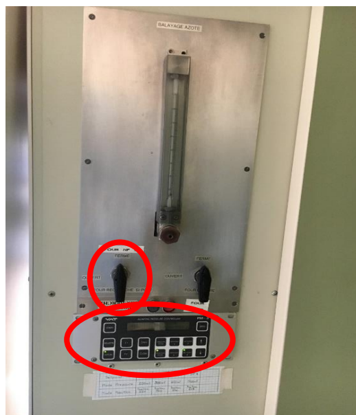
Figure 10 : vanne \text{N}_2 purge (à gauche) et contrôleur de la vanne papillon (dessous).
