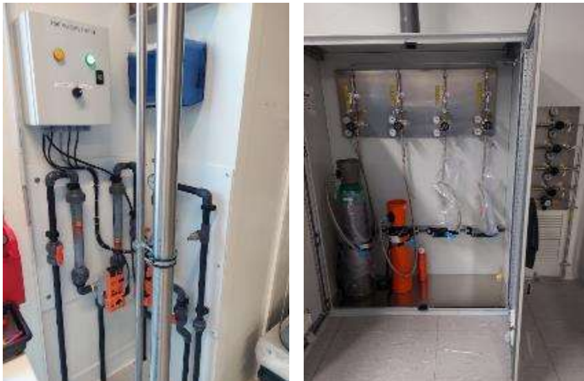
A gauche, automate de bascule d'eau de refroidissement. A droite, armoire gaz process
