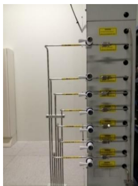
Figure 8 : Réseau des vannes de gaz
