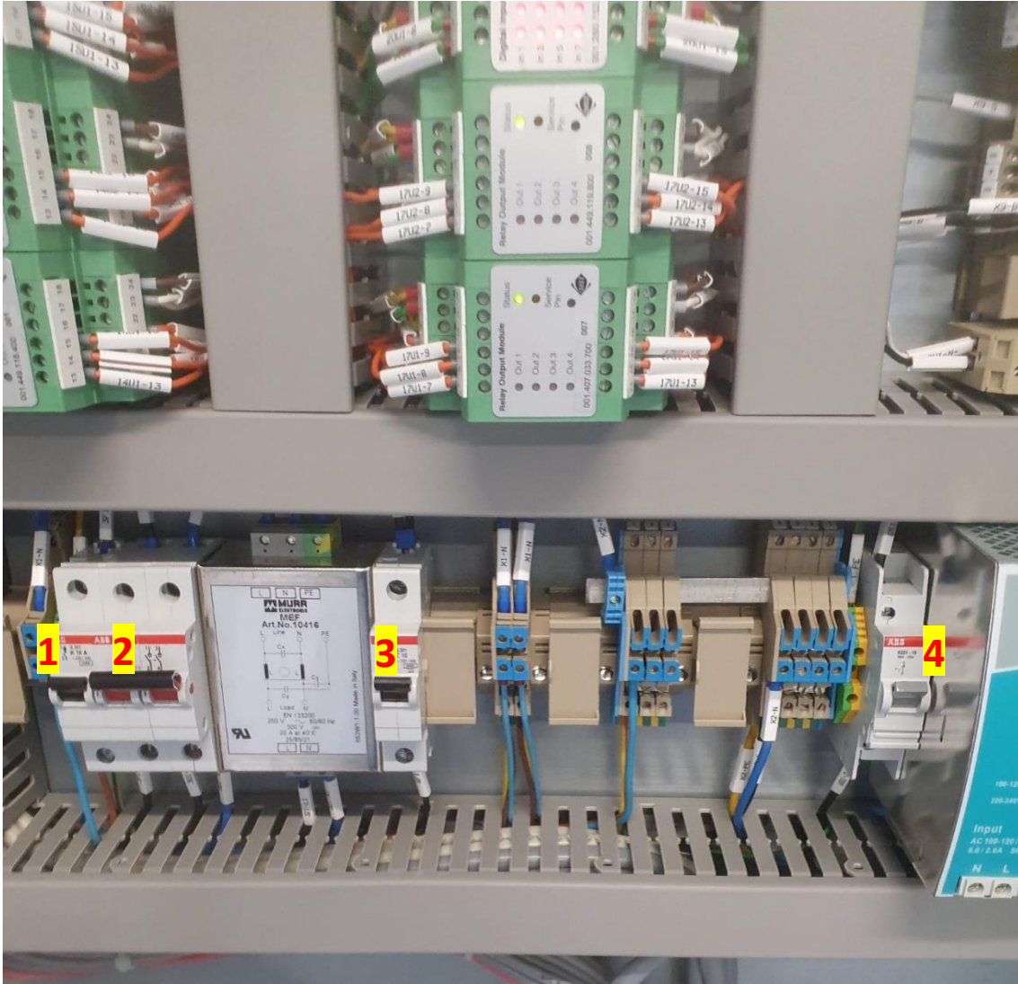
Figure 3 : Armoire électrique « MST1 »
