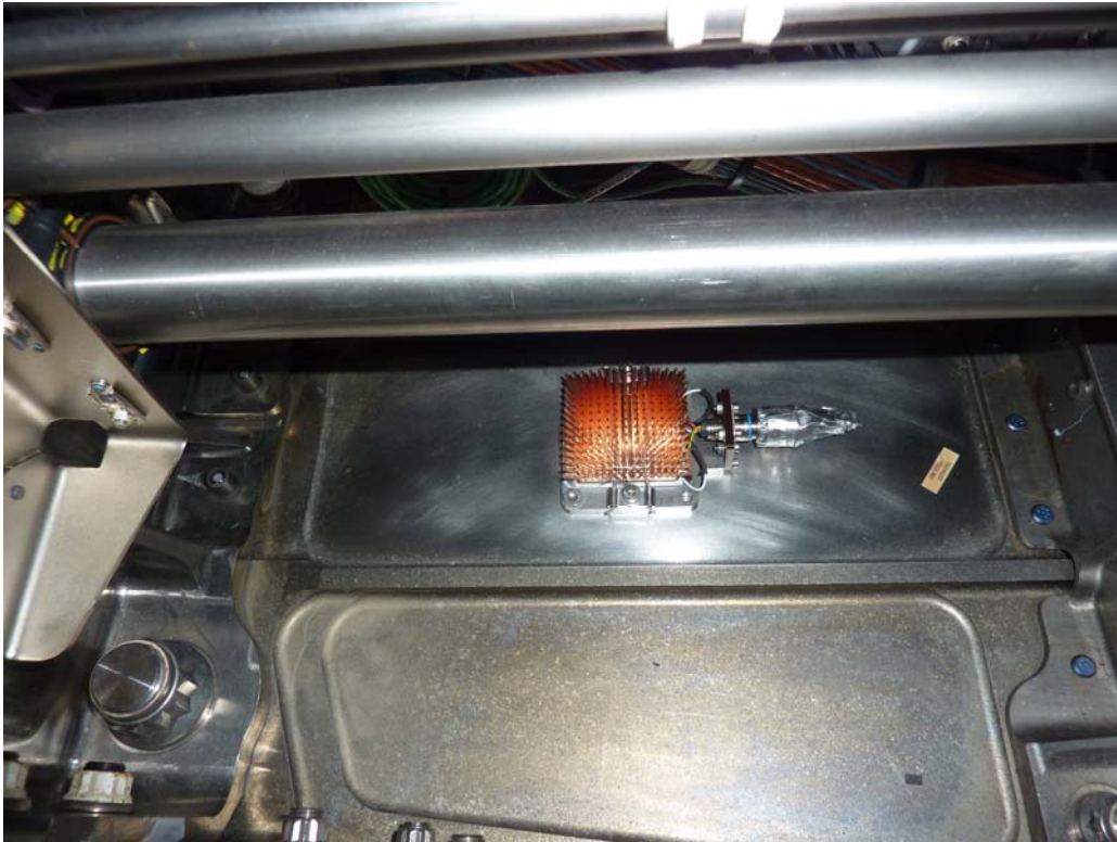
Figure 174. Le module thermogénérateur fixé dans le mât réacteur de l'A380 d'essai, non connecté au reste du système.
