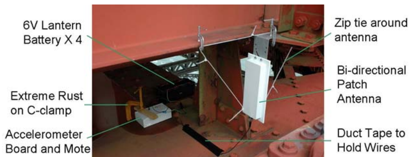
Figure 9. Un des 51 accéléromètres placés sur le Golden Gate Bridge à San Francisco pour surveiller les contraintes sur la structure du pont [22], [27].
